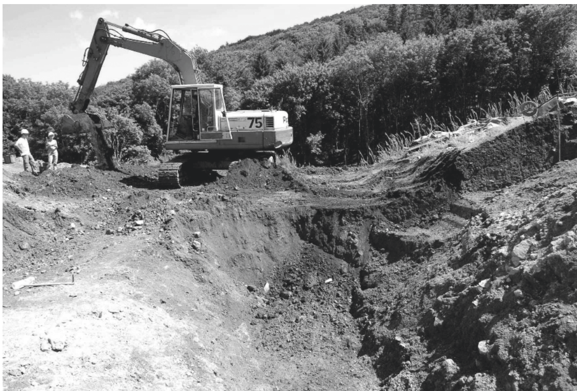
11. Bibracte, Mont Beuvray, Pâture des Grangerands. Evacuation mécanisée du comblement supérieur de la mine (zone 1).
