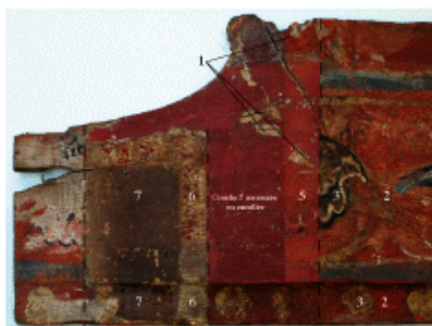
Polychromie originale préservée - Deuxième repeint en badigeon brun - Craquelures anciennes - Repeint rouge fait dans la gorge - Polychromie originale déglacée
