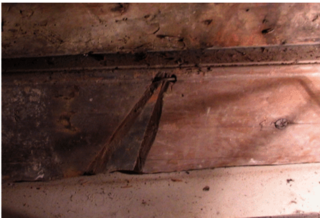
Fig. 7 : Rainures dont la distance et l'inclinaison les rendent sécantes sur l'arrête inférieure de la solive.
