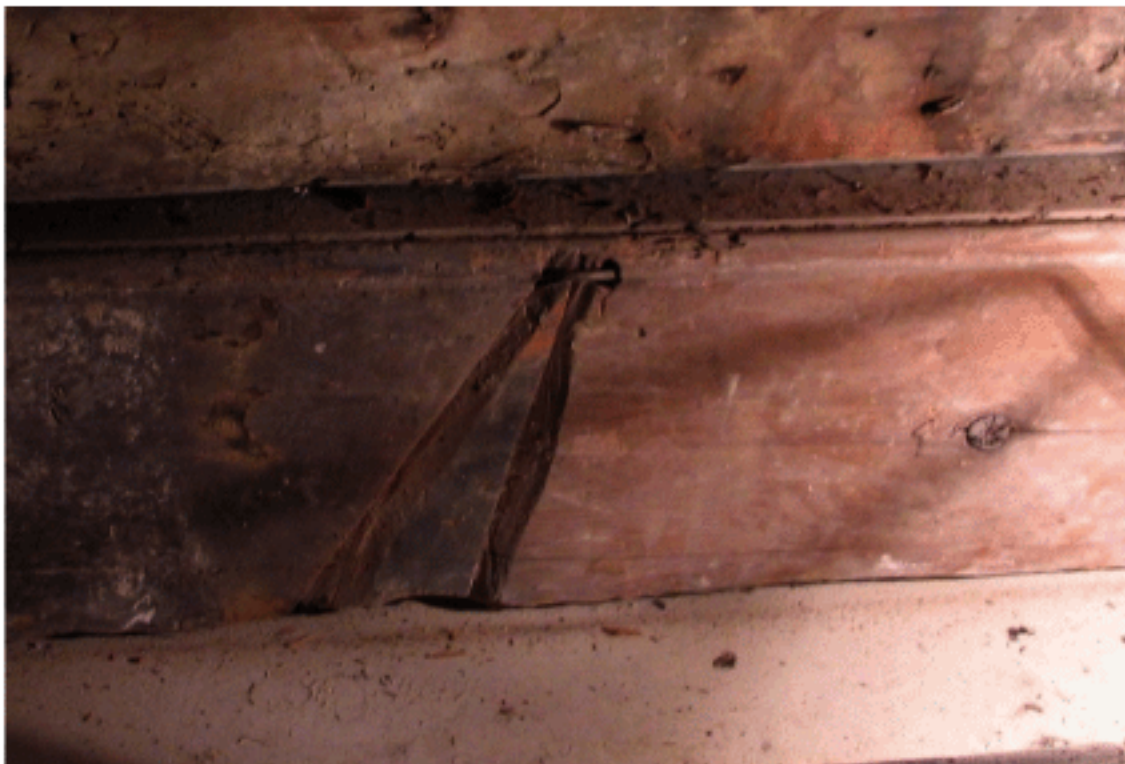
Fig. 7 : Rainures dont la distance et l'inclinaison les rendent sécantes sur l'arrête inférieure de la solive.
