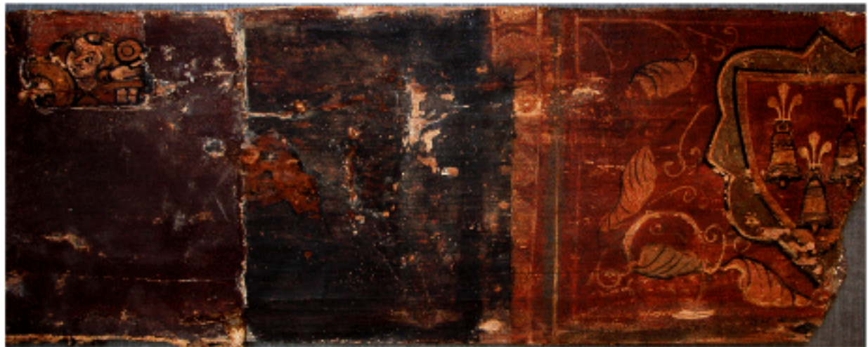
Fig. 15 : Fragment de bandeau en cours de dégagement. La polychromie originale (sondée en haut et à gauche ; dégagée à droite) est complètement opacifiée par un épais dépôt de suie (séquence noire au centre). (cliché P. Maritiaux, LA3M)
