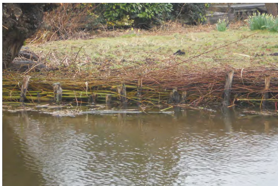
■ Fig. 148 : Exemple de berges aménagées à l'aide de poteaux, piquets et clayonnage.
