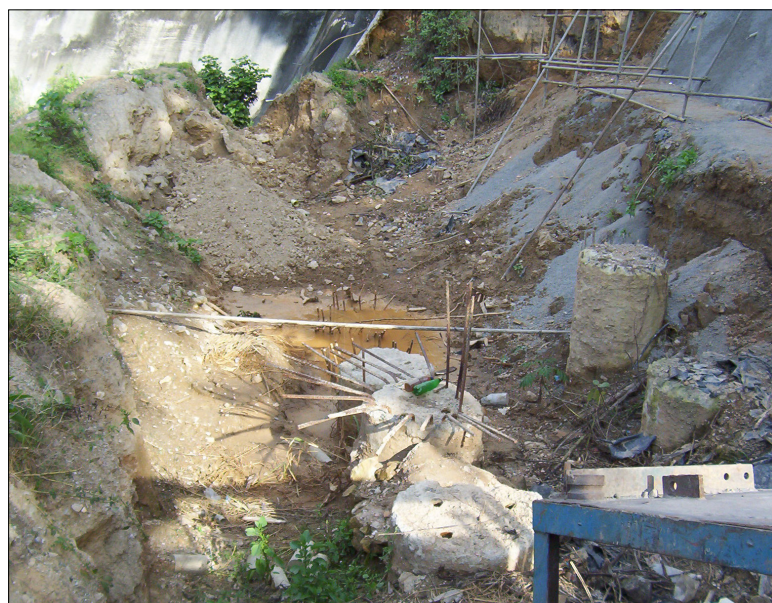
Figure 7. « Clou » en béton armé destiné à stabiliser le remblai meuble grâce à un ancrage dans la roche mère, en profondeur
