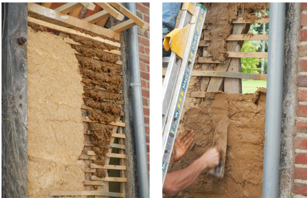
Fig. 5. Particolare messa in opera di torchis : il torchis viene applicato sulla trama lignea dall'interno e l'impasto che sborda sulla facciata esterna della parete viene in seguito liscio (Cantiere di restauro gestito da Ely Gontrand (artigiano) a Etrejust (dipartimento della Somme, Picardie, Francia).
