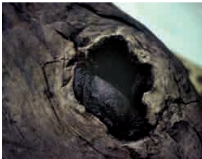
Fig. 13. Bouchon d'étoupe à base de tissu poissé dans un nœud (photo É. Rieth).
