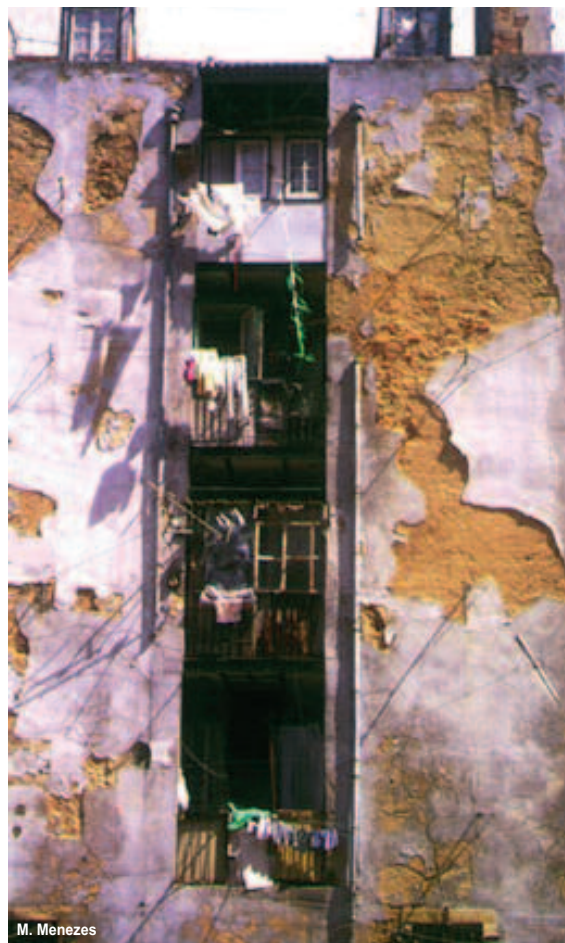
fig. 4 Immeuble dégradé du quartier de la Mouraria
