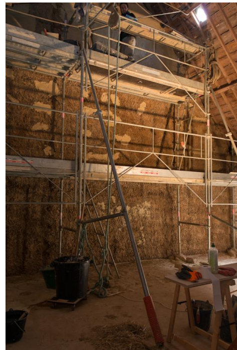
Une ossature en bois faite avec de grosses planches permettra de rentrer et de soutenir les bottes de paille qui doivent être bien comprimées en hauteur et en largeur.
