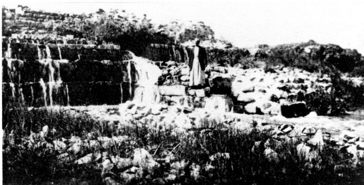
Figure 14 : Partie centrale du barrage du lac de Homs, vue de l'aval ; infiltrations à travers la paroi (Brossé 1923, pl. XXXVI 2).
