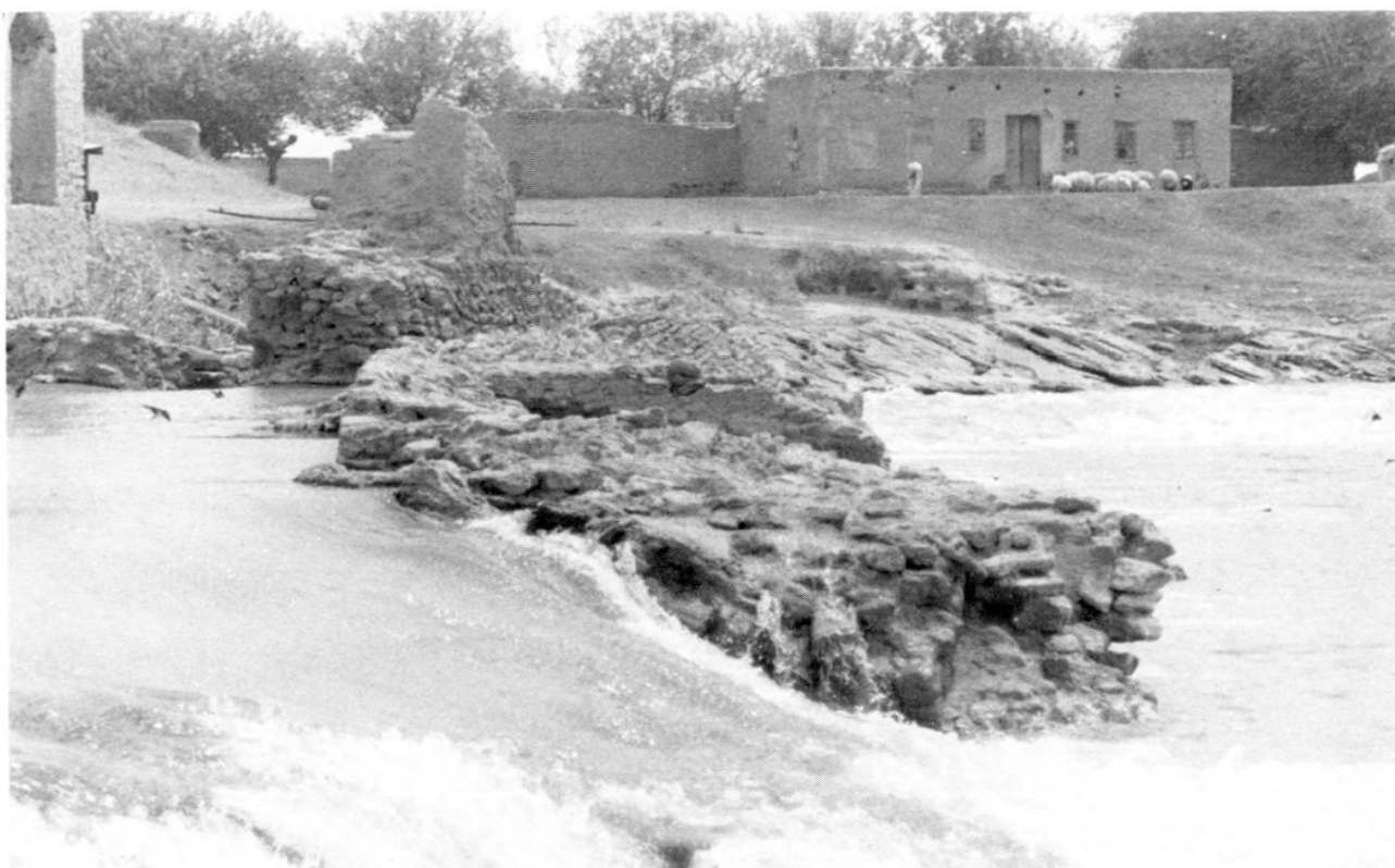
Figure 18 : Barrage d'ar-Rashdi ; détail de l'appareillage, à la faveur d'une rupture de l'ouvrage.
