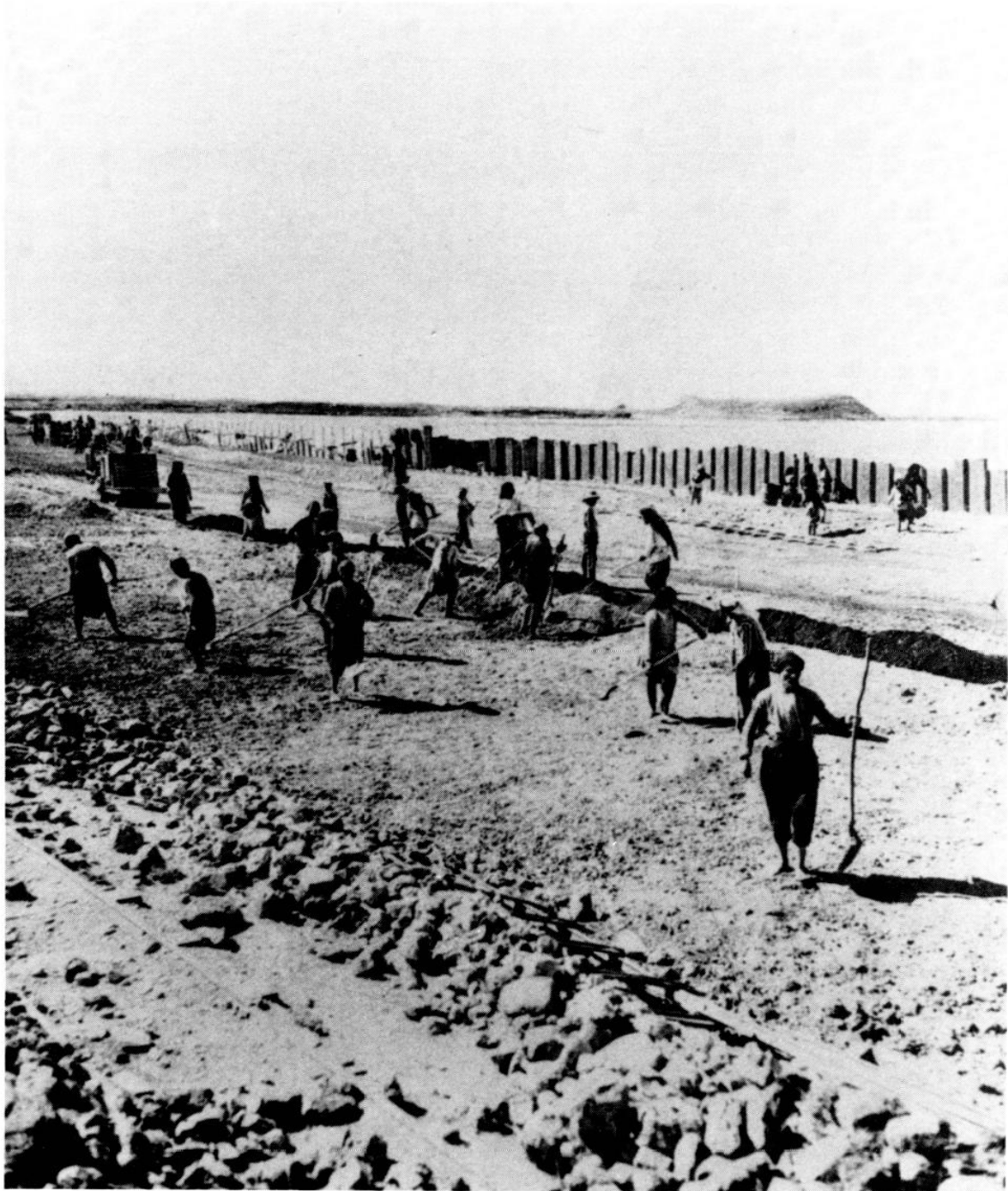
Figure 9 : Réaménagement du barrage du lac de Homs ; au fond, le tell de Qattiné (Weulersse 1940 a, pl. II 3).
