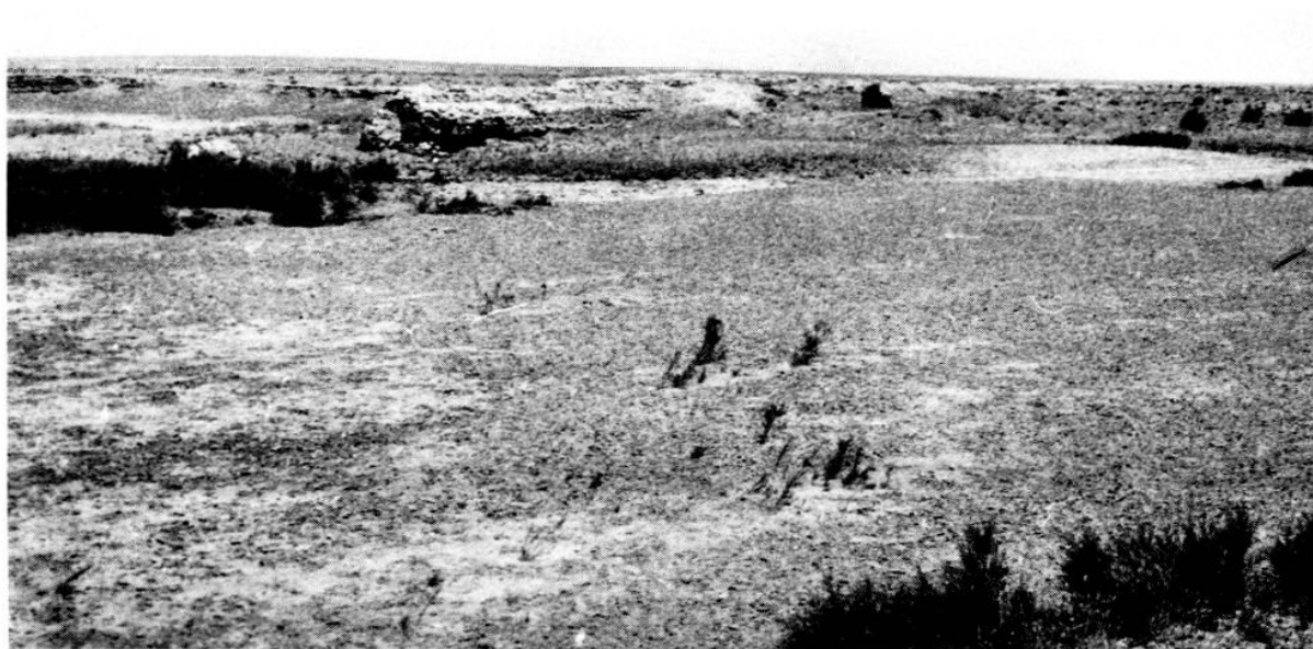
Figure 60 : Le barrage du wadi as-Souab, vu de la rive droite ; à gauche de la photographie, la rupture de l'ouvrage.
