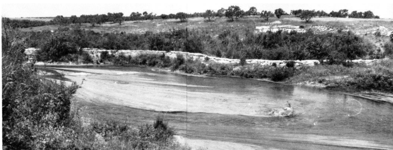
Figure 30 : Le barrage de Qal'at al-Araymeh, vu de l'amont ; la rupture est à l'extrême gauche de la photographie.
