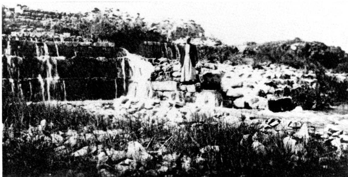
Figure 14 : Partie centrale du barrage du lac de Homs, vue de l'aval ; infiltrations à travers la paroi (Brossé 1923, pl. XXXVI 2).
