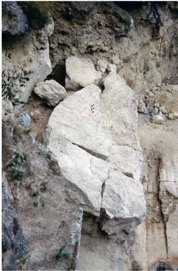
Figure 13. : Plafond de l'abri éroulé (cliché J. T.)
