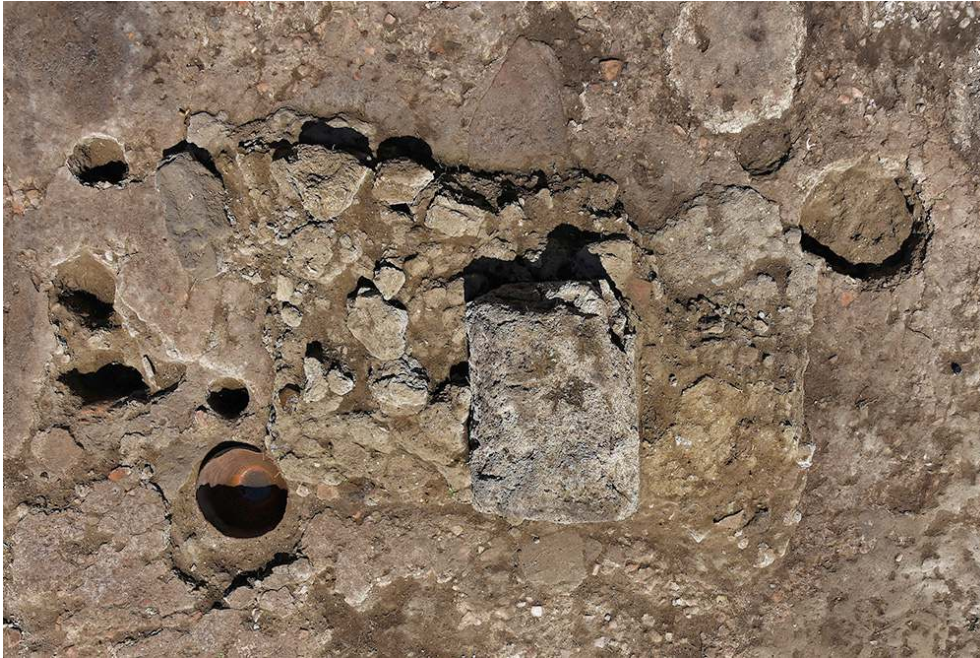
Fig. 24 – Boutique N20. Massif maçonné et aménagements périphériques, possibles traces d'un atelier de métallurgie du fer.
