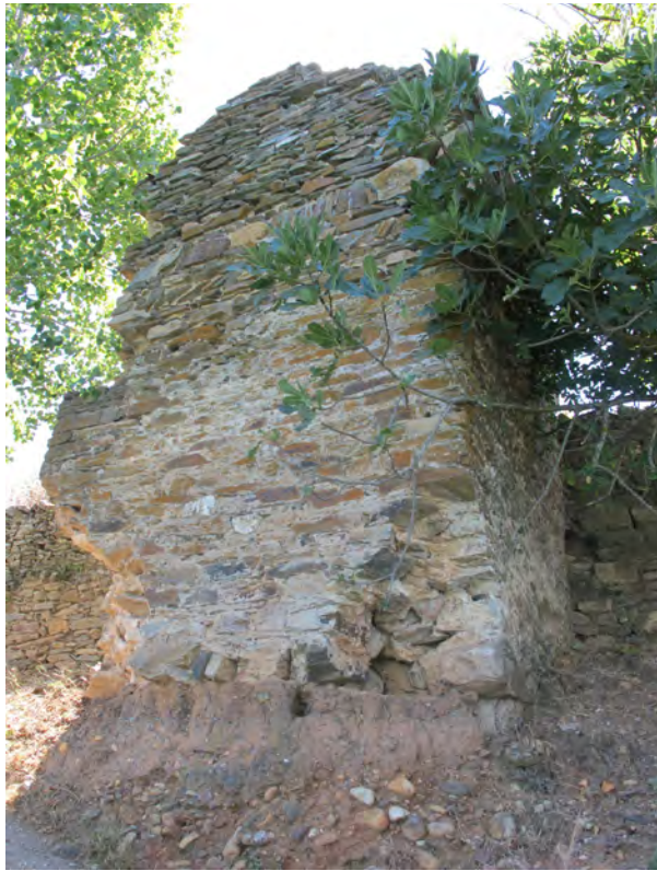
Fig. 14. Frente norte con la torre T7 levantada sobre el substrato fluvial (© Proyecto Albalat, 2011)
