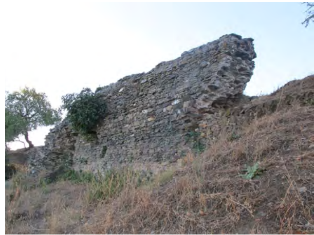
Fig. 15. Frente norte con un paño de la 2ª fase, flanqueado por la torre T8 (© Proyecto Albalat, 2011)
