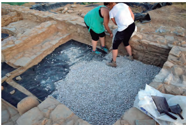
Fig. 22. Protección de los suelos de tierra apisonada con una malla antihierba y una capa de grava
