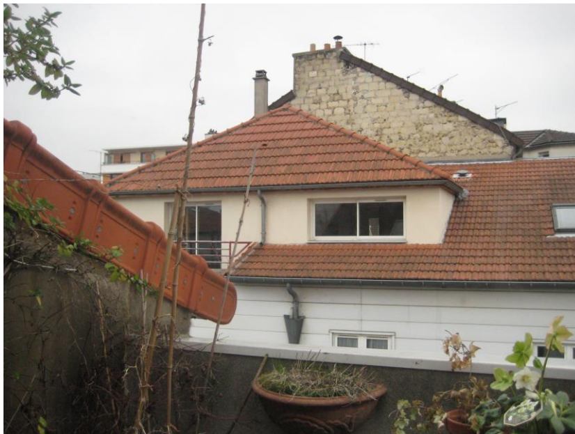
Figure 32 : Ajout d'une chambre supplémentaire au lot n° 1. Crédits photographiques : Auteurs du rapport ; janvier 2011.
