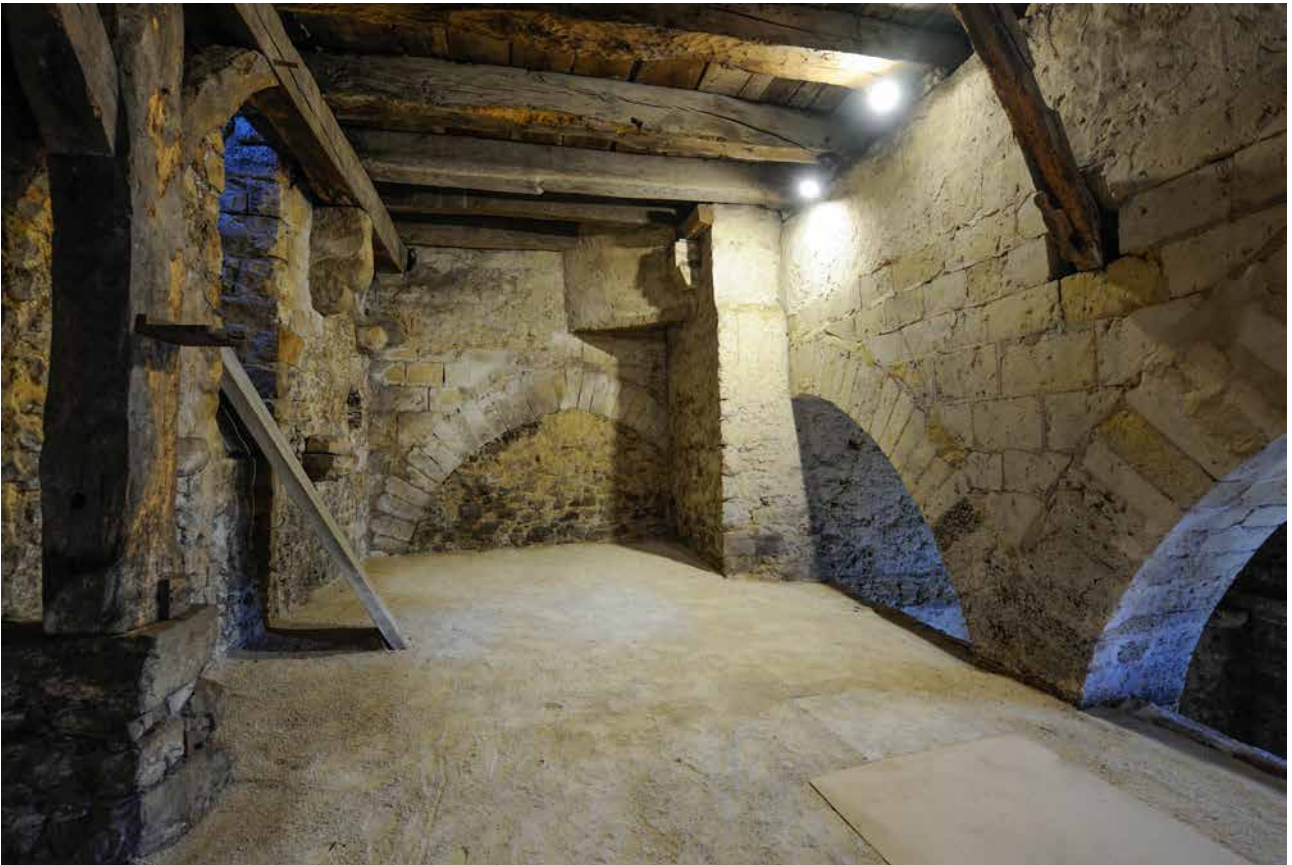
Fig. 9 - Plancher intermédiaire et files d'arcades perpendiculaires. A gauche, portique en bois du XVIII e s. Noter la surélévation des murs de refend percés d'arcades (G. Faulin - 2015)
