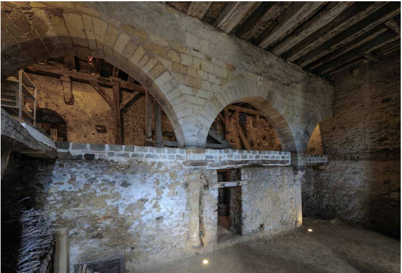
Fig. 8 - Salle basse de la maison canoniale Saint-Pierre. Refend percé d'arcades soutenant le plafond rehaussé (XII e s.). Plancher intermédiaire conservé sur la moitié est, une partie des arcades comblée par des maçonneries du XVIII e s.. Au fond portique en bois du XVIII e s. ( G. Faulin, 2015)
