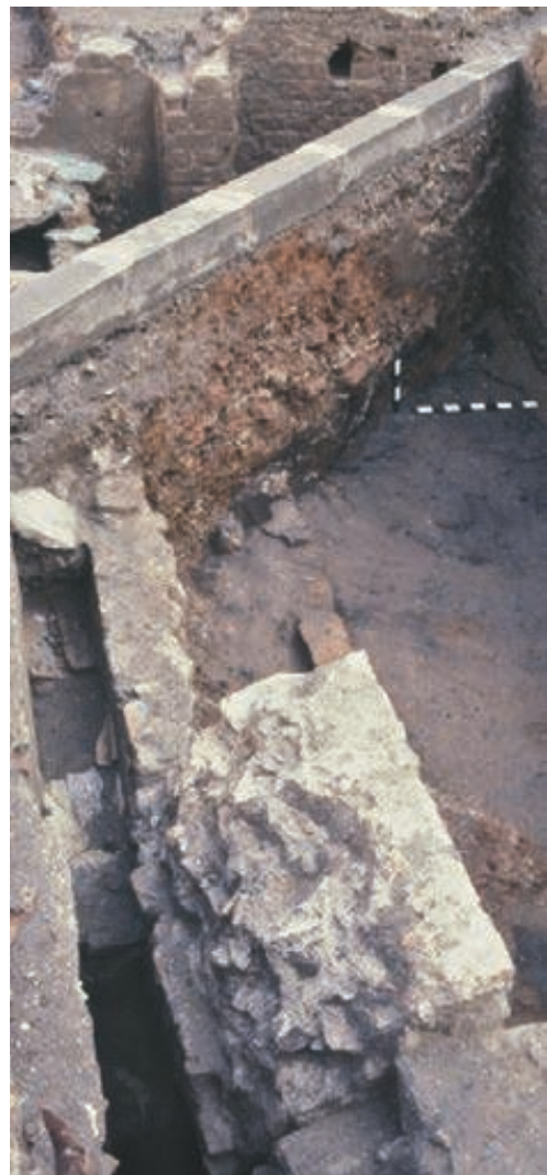
Figure 424 - Place Formigé. Phase 3. Puits-regard (au premier plan) de l'égout de gabarit domestique. Vue prise vers le nord (cliché L. Rivet).
