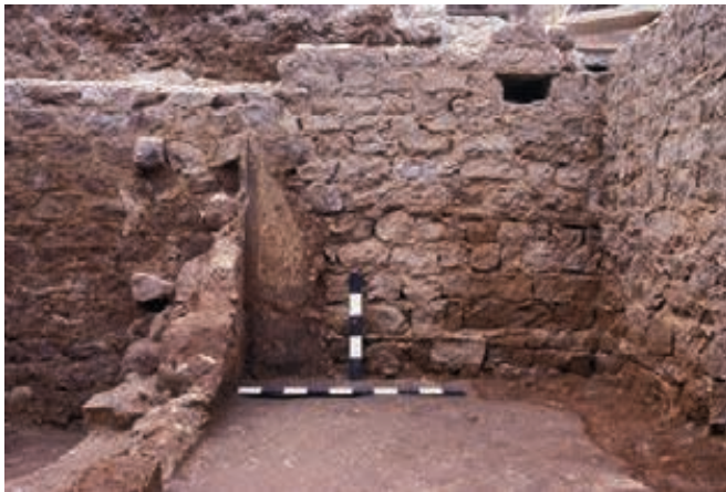
Figure 282 - Place Formigé. Phase 2. Élévation du mur 13 fermant la boutique 2, au nord, en petit appareil aux joints repris au fer et conservant une plinthe d'enduit peint. Vue prise vers le nord (cliché L. Rivet).
