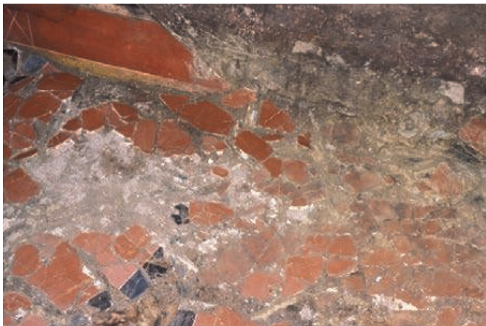
Figure 325 - Place Formigé. Phase 2. Tablinum 6 . Peintures murales effondrées dans l'angle des murs 22 et 9. Vue prise vers le nord-ouest (cliché L. Rivet).
