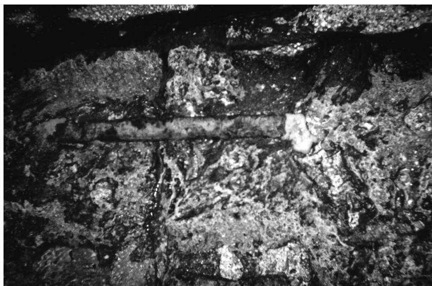
FIG. 9. Pennedepie (14). Détail d'une agrafe métallique jointoyée au plomb
