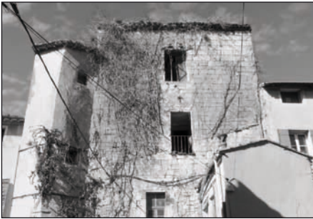
Fig. 5: Façade de la tour Chauvet de Pernes-les-Fontaines avec un escalier à vis du XVI e siècle (Cliché M. Dadure, Direction du Patrimoine de L'Isle-sur-la-Sorgue, 2016)
