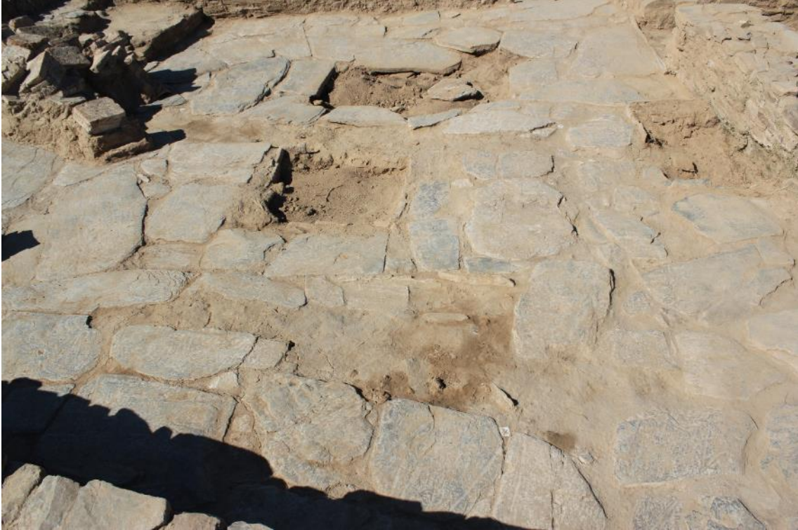
Fig. 4. Aspecto del patio central tras la retirada de las protecciones temporales al inicio de la campaña. Pueden verse las faltas estructurales en las lajas de pizarra del suelo y del arriate, así como los ladrillos que delimitan la boca del aljibe.
