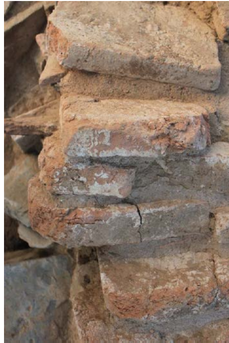
Fig. 9. Disgregación de algunos ladrillos del arco derrumbado sobre el patio (UEC2263 y UEC2267). También pueden verse numerosas grietas y fisuras, concreciones carbonatadas y eflorescencias salinas de color blanco.
