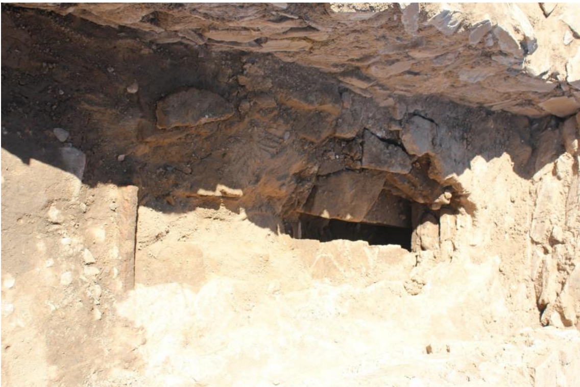
Fig. 8. Canalización de la Estancia L, donde se han desprendido algunos ladrillos que en origen se encontraban adheridos con morteros de cal y arena.
