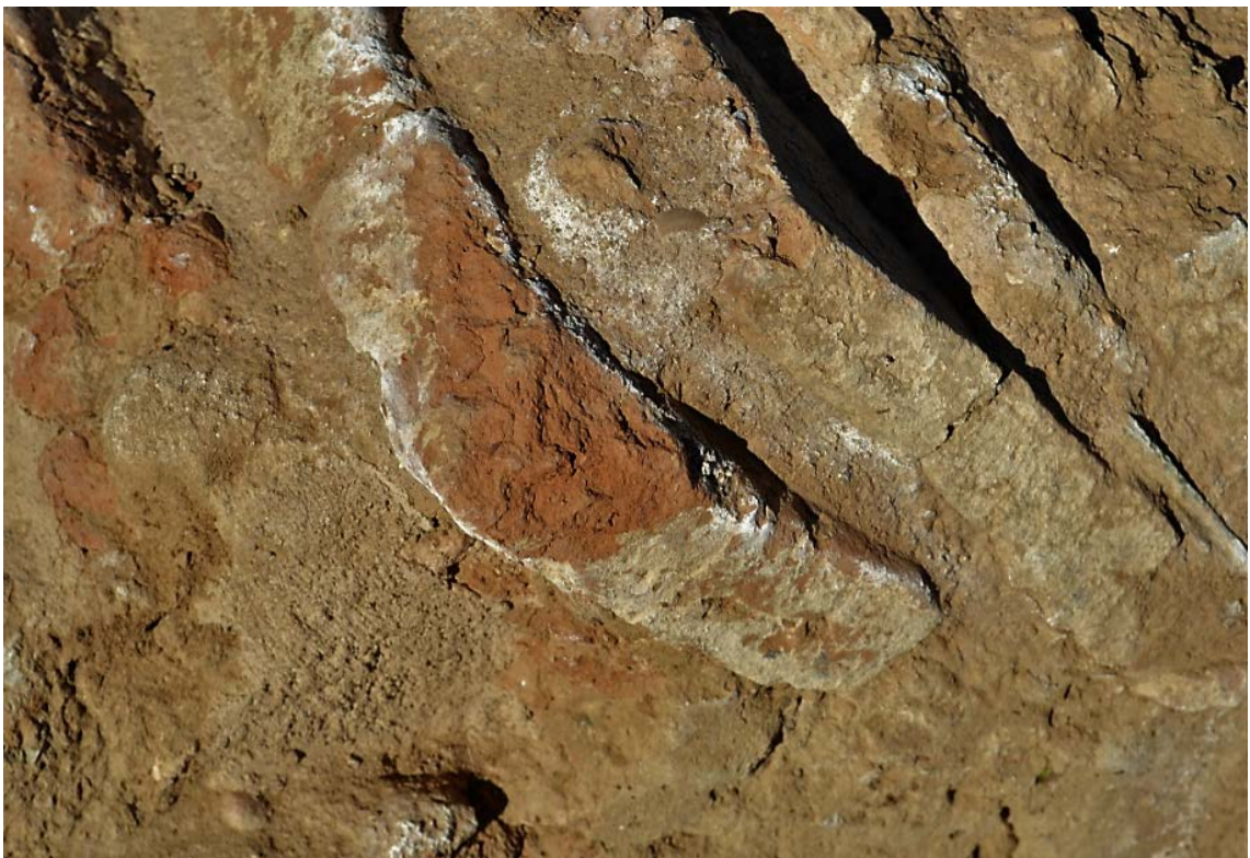
Detalle del estado de un ladrillo.
