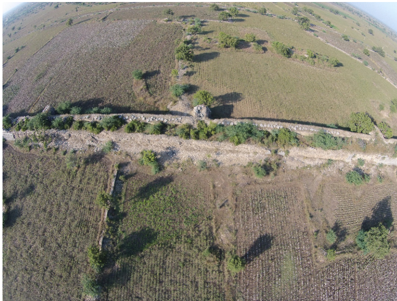
Figure 22 : vue de l'enceinte nord. Les merlons sont démontés sur le sol de la courtine
