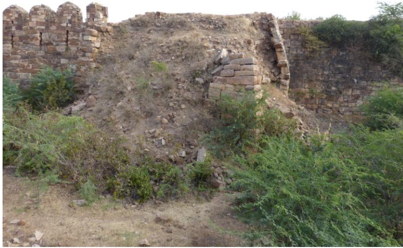
Figure 59 : l'état de ruine de la tour 47 montre la stratigraphie des remblais et des niveaux de sols de circulation d'origine du bastion (sol légèrement chaulé) ainsi que la mise en oeuvre de la maçonnerie avec un fruit prononcé. La tour est adaptée à la circulation des archers.
