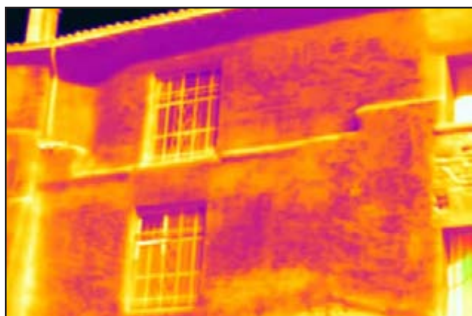
Figure 175b : cliché thermique de la façade occidentale
