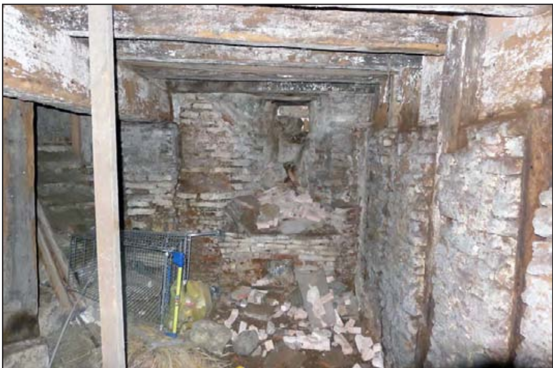
Figure 54 : bâtiment B, le sous-sol occidental vu depuis le sud. Au centre, l'ancienne fenêtre du mur nord
