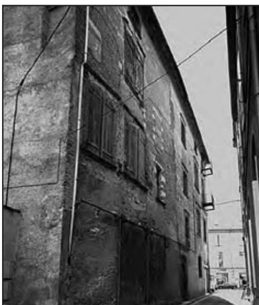
Figure 31 : Elevation nord sur la rue Caillavet. Cl. Inventaire Midi-Pyr. 85.82.1068.V J.-F. Peire [1985]
