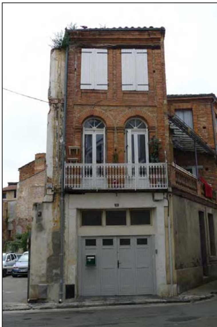
Figure 163 : vue générale de la façade orientale, donnant sur la rue des Mazels
