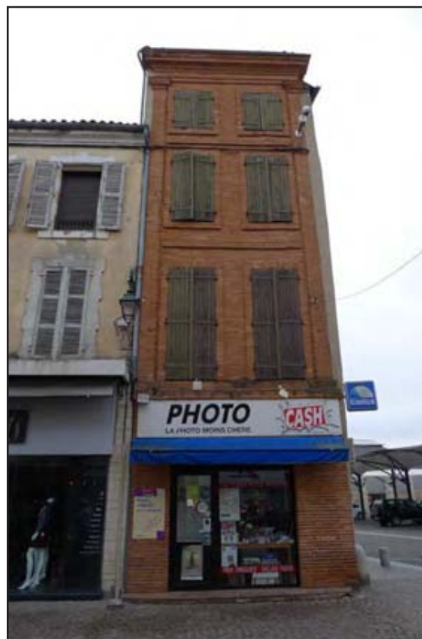
Figure 94 : vue générale de la façade occidentale, donnant sur la rue de la République
