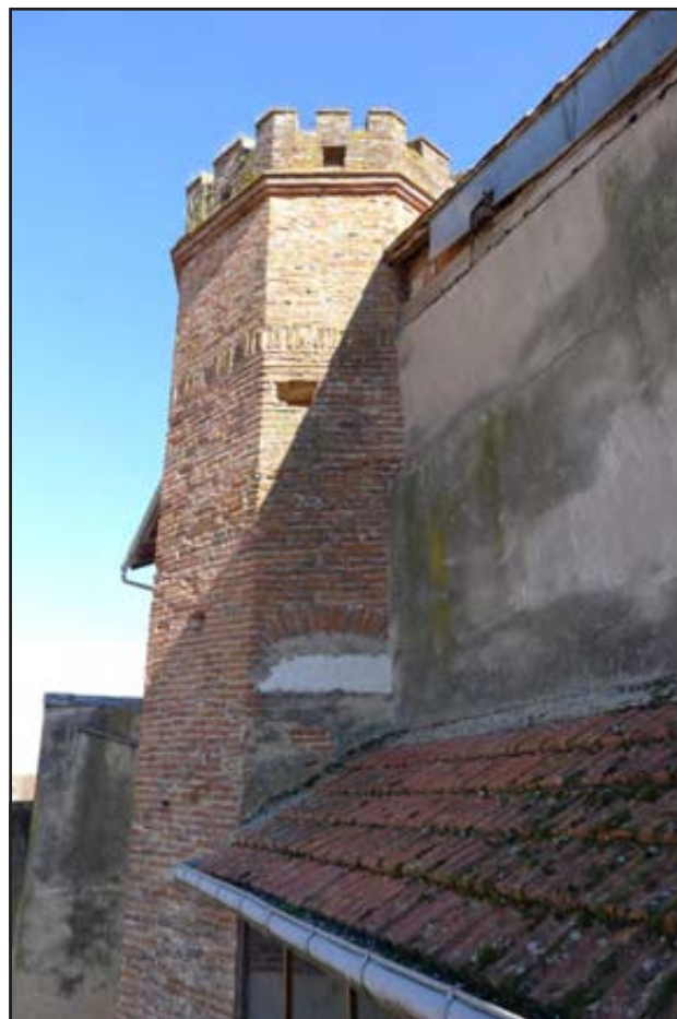
Figure 61 : bâtiment B, partie supérieure de la tour. On distingue l'ancien accès à la galerie et la surélévation de la tour.
