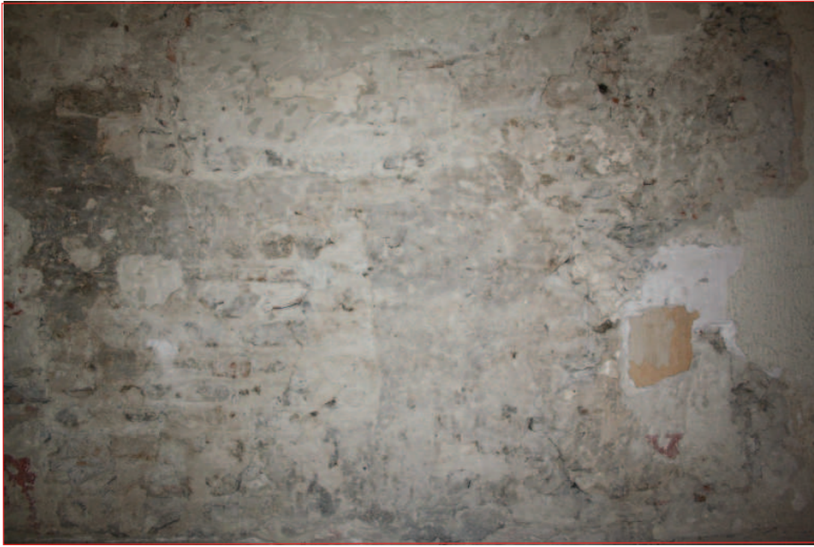
Mur sud M 21 : perturbations de la maçonnerie (IMG_0766)
