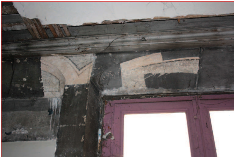
Mur ouest M 1 : fenêtre F 32. Enduit peint sur le linteau (IMG_0839)
