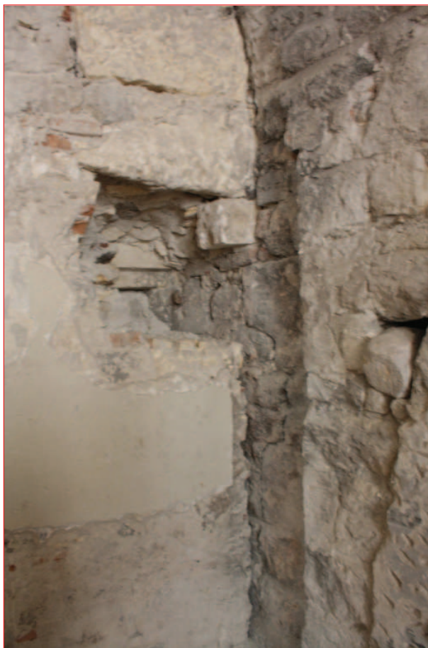
Angle du mur est M 4 et du mur sud M 2 (IMG_0796)
