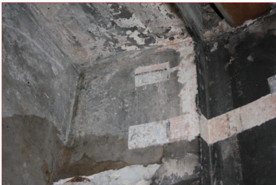
Mur sud M 2 : détail des enduits peints sur le piédroit ouest de la fenêtre F 34 (IMG_0832)
