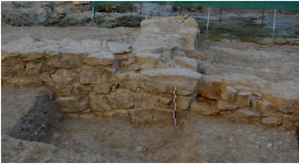
Fig. 31 : fondation continue du mur MR2021 (=MR2027=MR2306) à l'est du pilier MR2022 (à l'arrière plan), le sud. Cl. O. Maufra/Inrap. [Photo n° 651].
