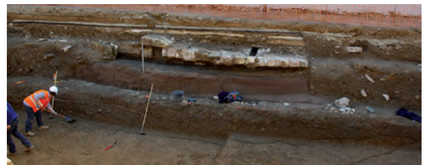
Fig. 1 : le collecteur d'eau usée CN1002 d'époque contemporaine en bordure orientale d'emprise. Cl. O. Maufras/Inrap. [Photo n° 2].
