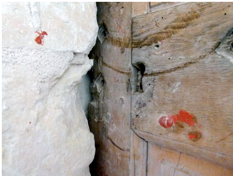
Figure 1. Vestiges de cachets de cire de scellés posés en 1750, 1755 ou 1790. (Château de Chambord, salle 13, cliché Denis Grandemenge)
