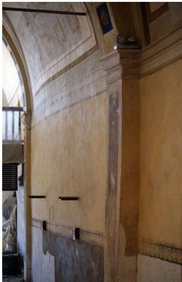
Fig. 54 : Chaine d'angle visible à l'intérieur et qui sépare la première de la deuxième phase de construction.
