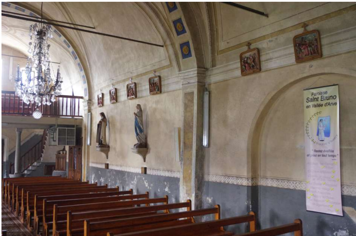
Fig. 50 : Mur nord-ouest à l'intérieur de l'église. © Département de la Haute-Savoie / L. Ceci.
