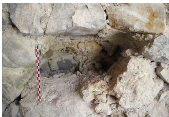
Fig. 55 : Arrachement dans le parement où est visible le doublement du mur par l'extérieur.
