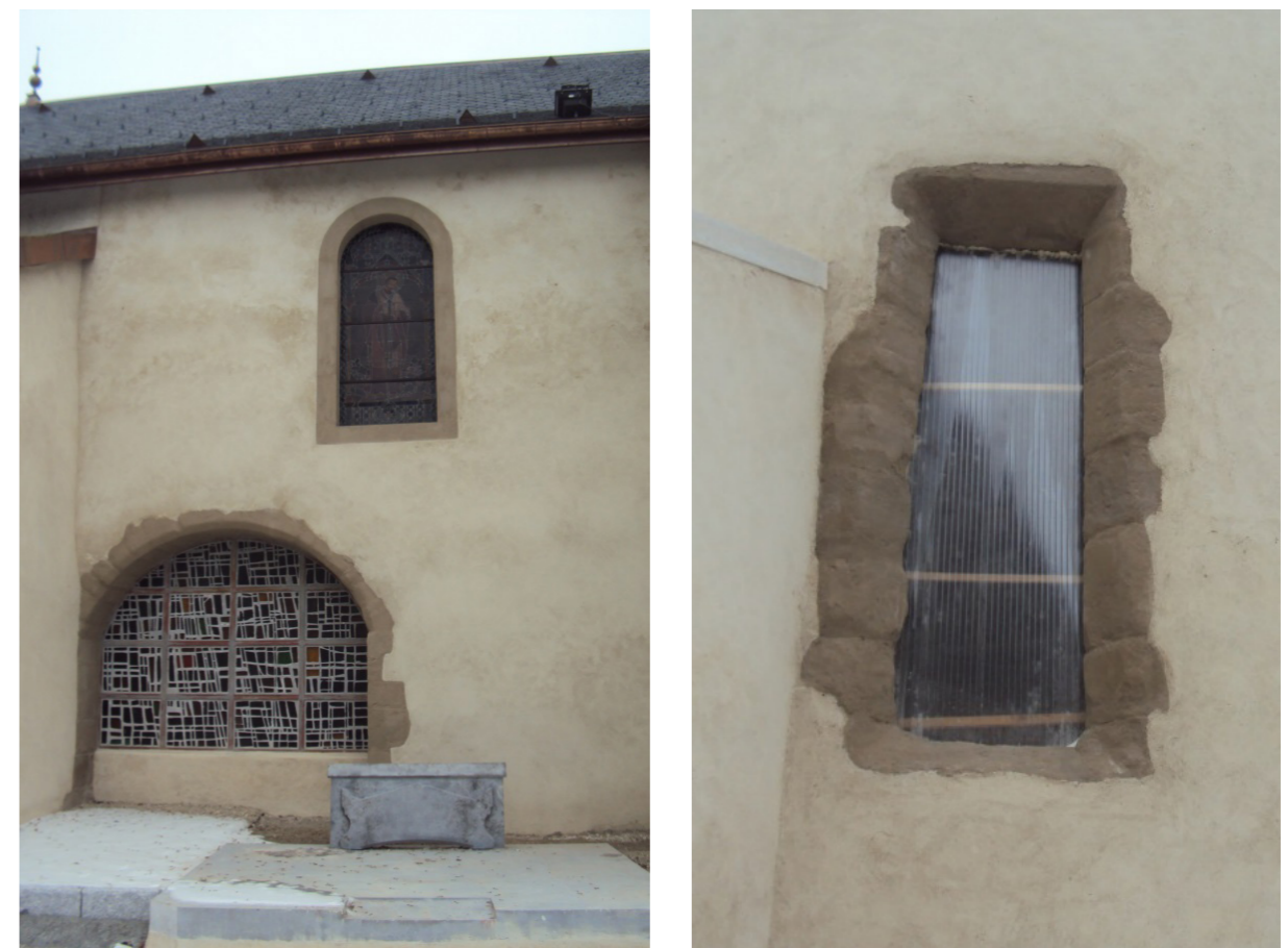
Fig. 6 : Encadrements d'origine en grès molassique et restauration en calcaire. Clichés : D. Decrouez (Géologue).
