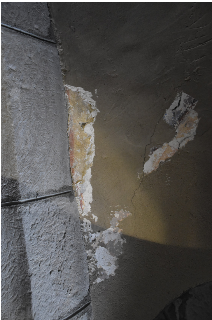
Fig. 49 : Enduits peints présent sous les couches peintes moderne de la voûte du chœur. Cliché : L. Benoit (UAPB).
