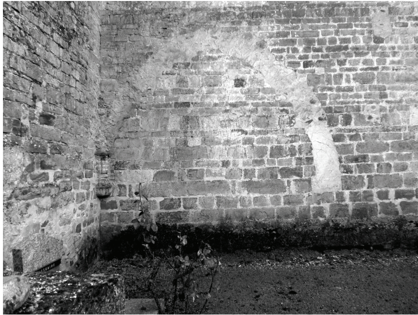
Fig. 14. Arrachement d'une voûte sur le mur nord de l'église. Photographie S.A.
