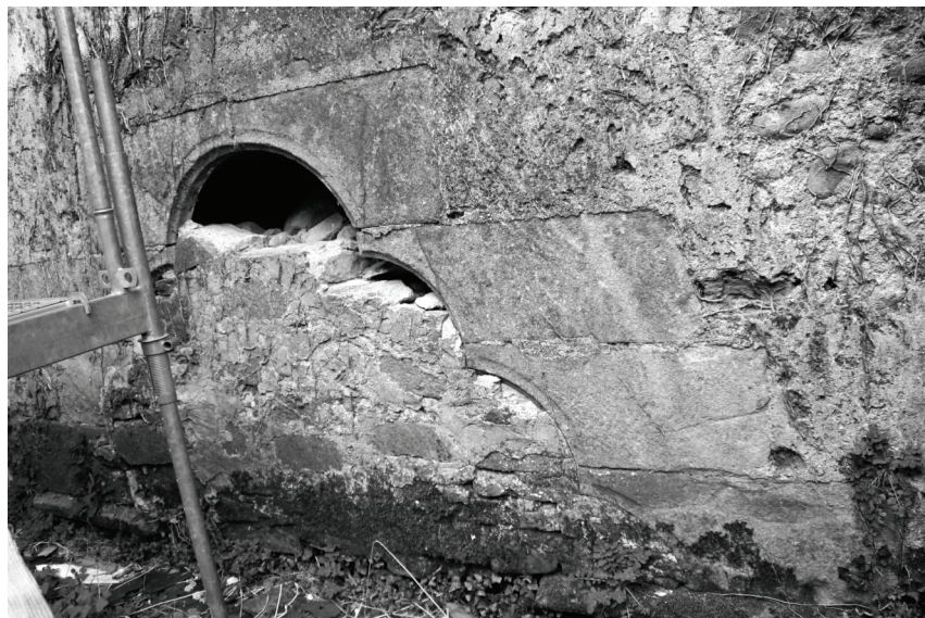
Fig. 13. Enfeu de style gothique sur le mur sud du chevet (XIII e s. ?). Photographie S.A.
