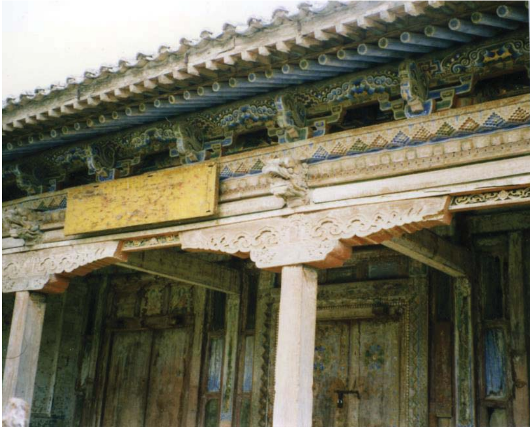
83. Jungyar juu (Ordos, état en 1995). Façade de la grande salle orientale présentant un soutien d'entablement tibétain et une charpente chinoise.
