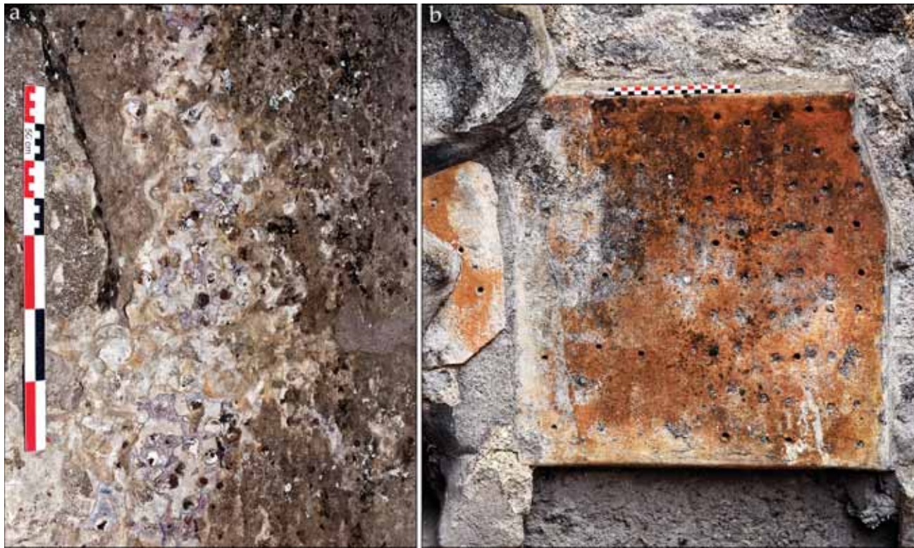
Fig. 88 – Pompéi, revêtements muraux contre l'humidité. a : plaque de plomb avec clous, de VI 12, 2-5; b : brique pour fixation avec clous, de V 1, 7.
