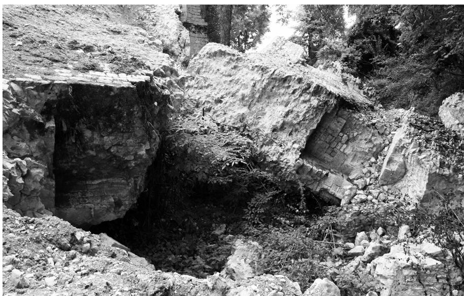
Fig. 8 - Guainville, Le Vieux Château, vue des deux parties de l'archère de la courtine C-D après effondrement de celle-ci en 2016.
