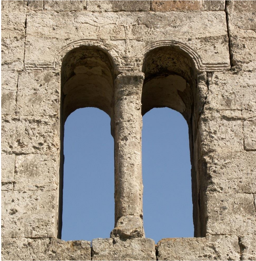
Fig. 12. Aštarak. Basilique Ciranawor (c. VI e s.). Fenêtre double de la façade O.
