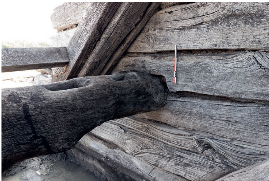
Figure 22 : Portique - Entretroise (XIX e s.) assemblée dans l'épaulier sud - Vue depuis l'EST.
