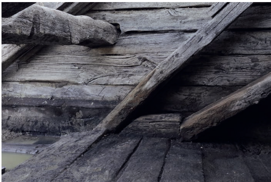
Figure 20 : Portique - Épaulier sud - Jambes de force retenue par un sabot - Vue depuis le NORD.
