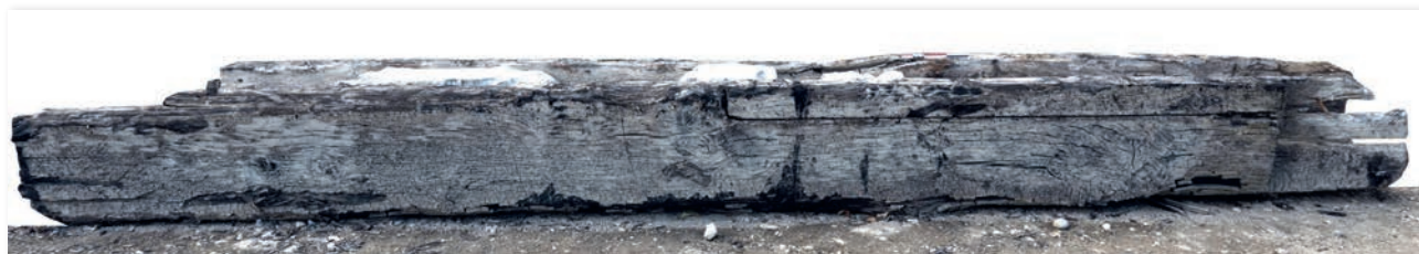
Figure 6 : Auge déposée lors des travaux sur la digue - Extrémités endommagées - 5,65 m de long.
