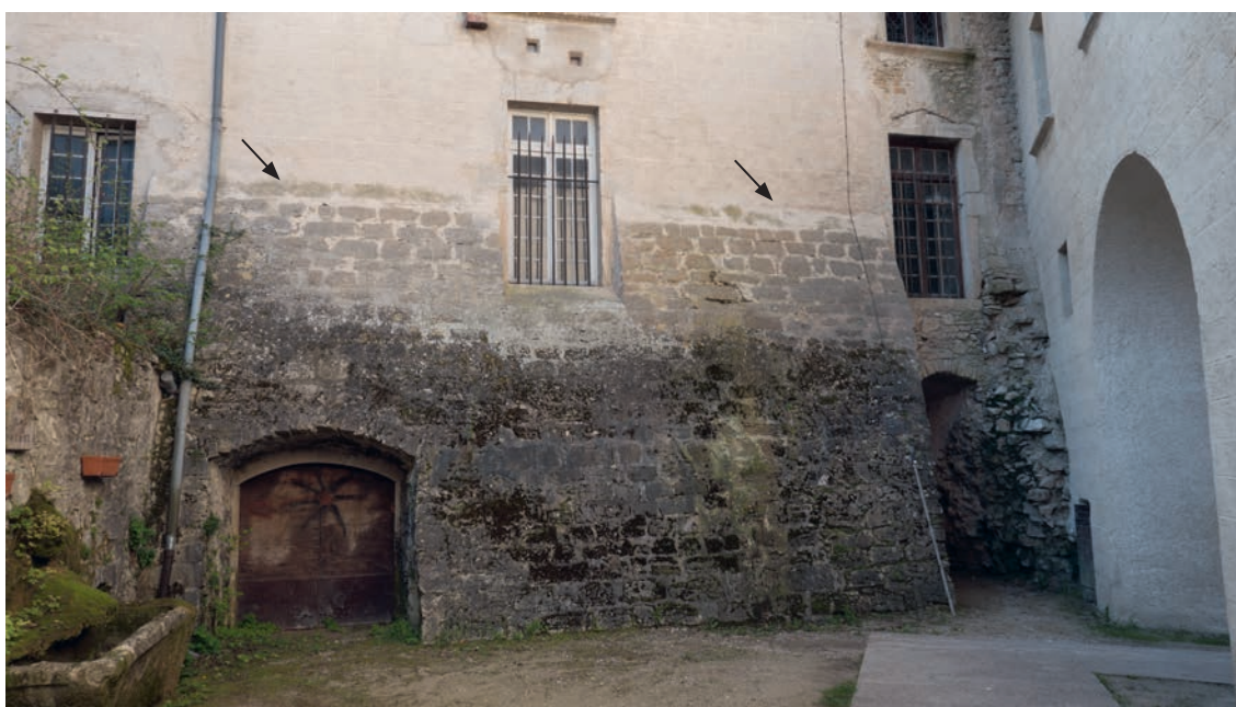
Fig. 11. Maison Graven , mur NORD à l'angle de la Tour des Archives, entrée des caves.
