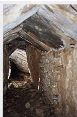
Pl. XVII. Fausses-galerie d'une construction particulièrement soignée sur le site de Mas-Cornier à Saint-Laurent-le-Minier (Gard) : des lauzes en bâtière reposent sur plusieurs dizaines de mètres de longueur sur des moellons de stèles parfaitement parementés. Cliché GEMA.
