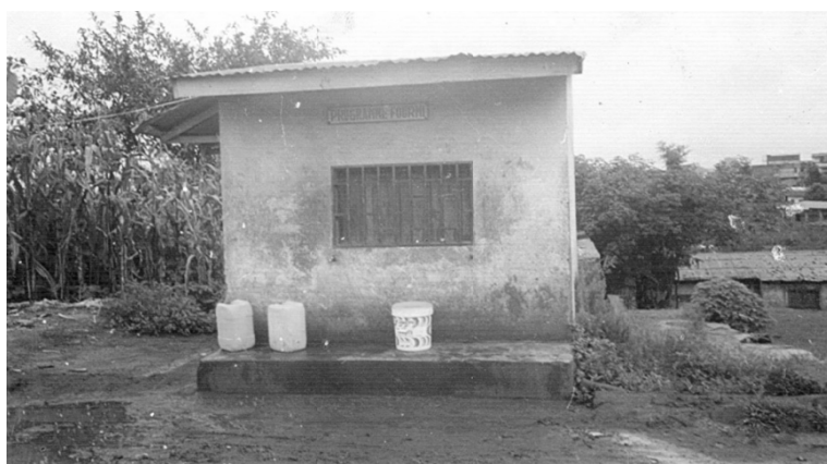
Photo 2 : Point d'eau SNEC du programme FOURMI au quartier Djeleng 5 à Bafoussam On peut apprécier le dispositif de sécurité marqué par la petite case dans laquelle se trouve la borne fontaine, ce qui évite le vandalisme sur l'ouvrage. Elle ouvre à des heures régulières.
