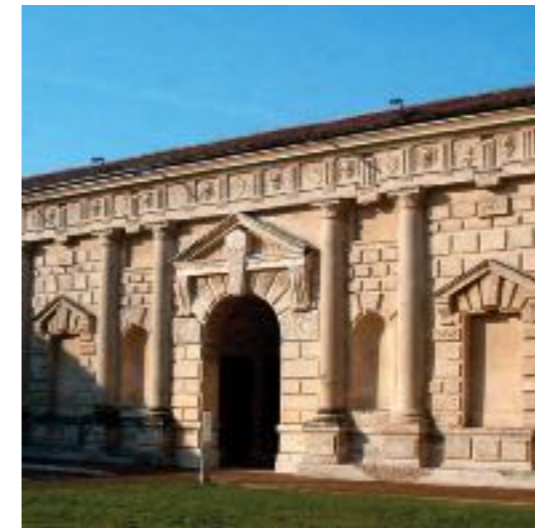
Fig. 1 - Cour intérieure du palais du Té à Mantoue (Giulio Romano, XVI e siècle : des pièces maîtresses de l'architrave ont glissé, mettant virtuellement en danger la stabilité de l'édifice (© Marco/Wikipedia).
