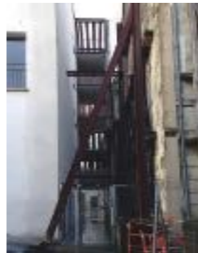
Fig. 9- Étais métalliques rue Bourbon, non prévus au permis de construire (© V. Caubet)
