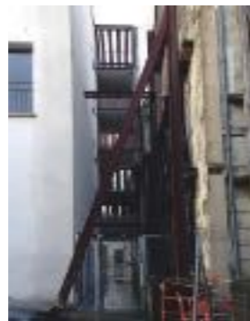
Fig. 9- Étais métalliques rue Bourbon, non prévus au permis de construire (© V. Caubet)
