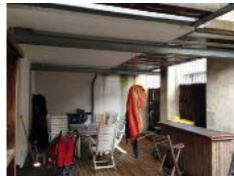
Fig. 10- Traces d'humidité dans l'espace intermédiaire entre les deux façades (© V. Caubet)
