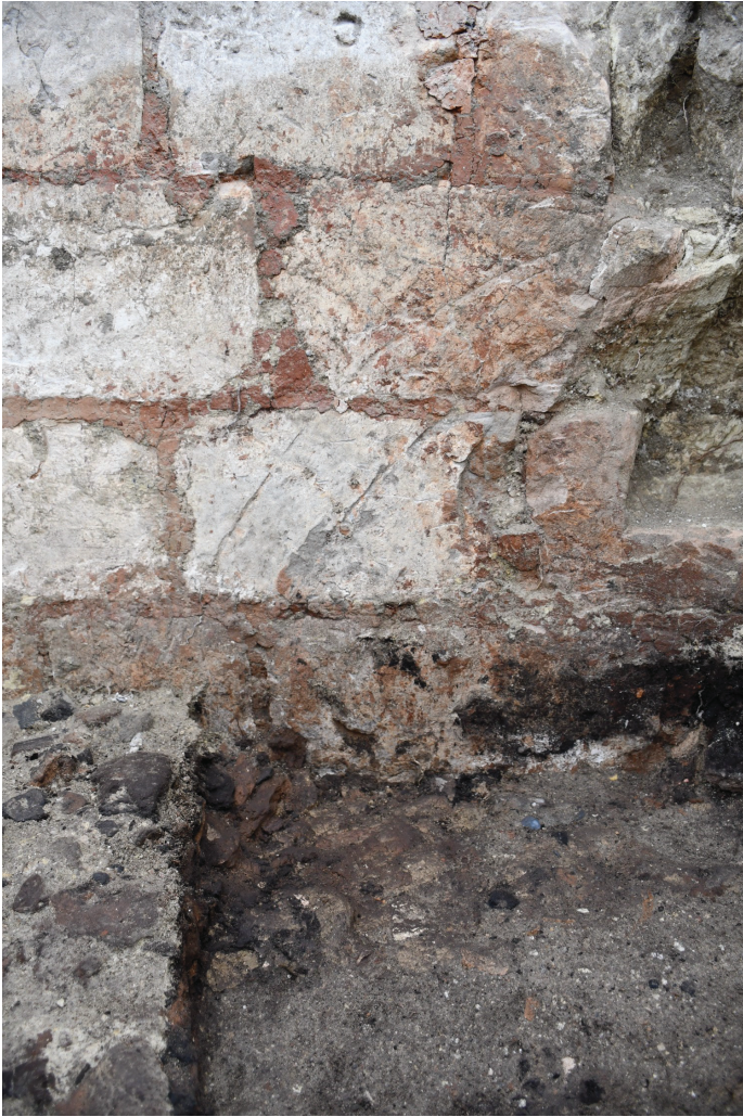
Griffures en arc de cercle observables sur le parement nord du four
