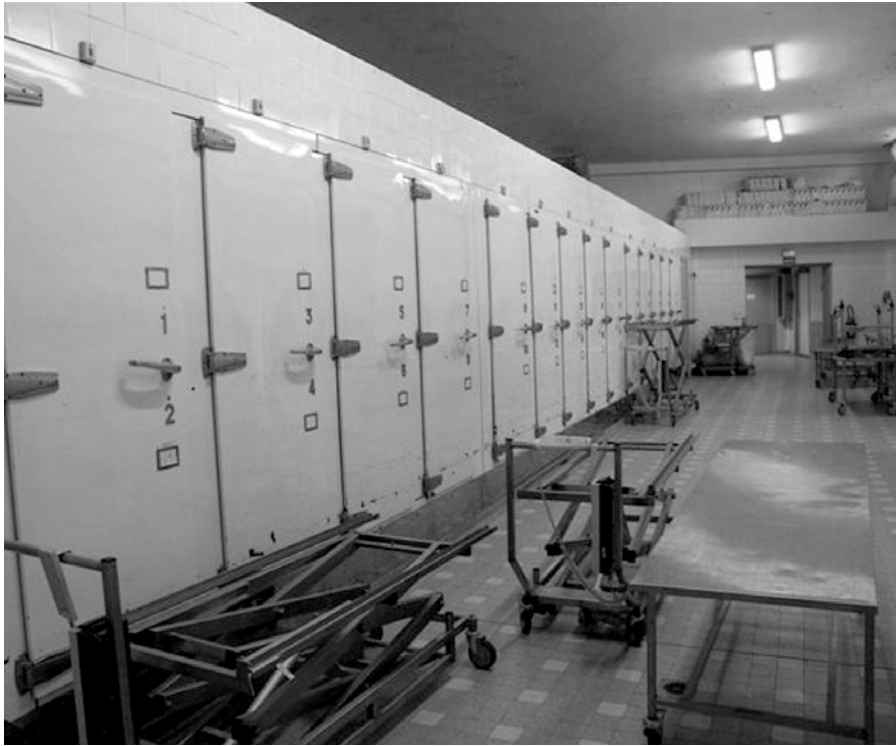
■ Armoires frigorifiques à la morgue (photo A. Jeanjean).
