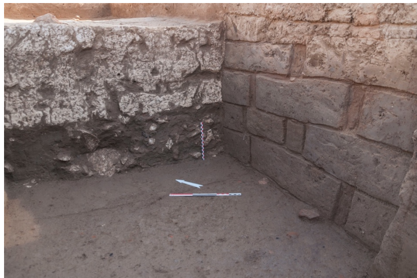
Fig. 22. Vue en coupe du mur MR1020 et de l'enduit de chaux blanc. © Y. Bourhim (17149_2019_NDMPF_015).
