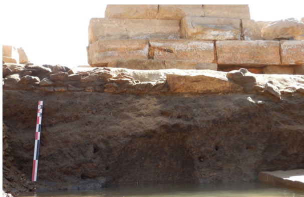
Fig. 6. Au premier plan, muret (SB076) en bordure de la fosse de fondation (FOS075) du mur arrière (1 re assise à droite) ; au second plan, le mur nord du déambulatoire et le sable de fondation (US062). © CNRS/C. Thiers (17149_2019_NDMPF_007).
