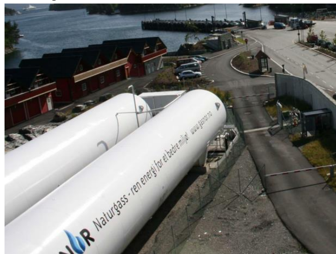
Stockage local de GNL en Norvège
