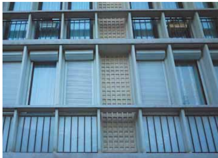
Ajout sauvage de volets extérieurs
