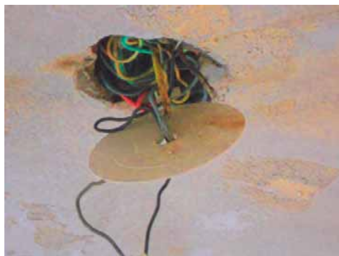
Ci-dessus et ci-dessous: Appartement en cours de travaux Photo Lucile Pierron BC-A
