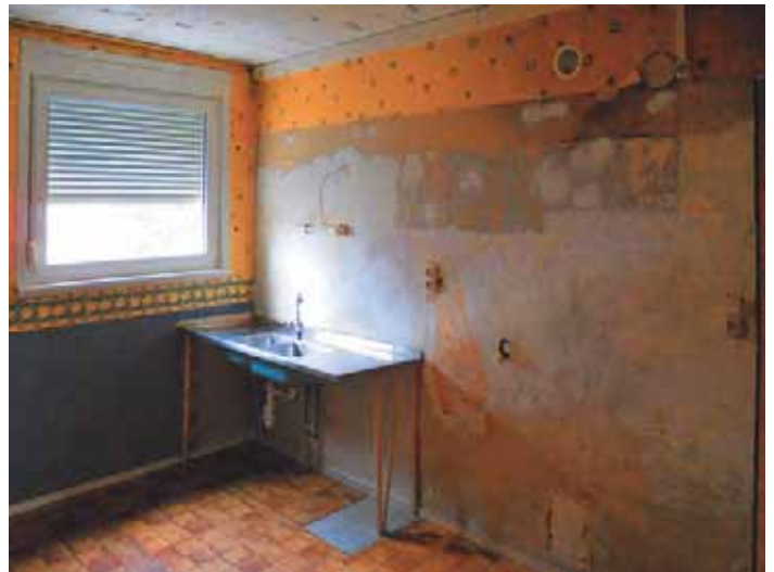
Appartement en travaux - Photo Lucile Pierron BC-A Ci-dessus: Le changement des fenêtres et la pose de volets roulants réduisent de manière importante le clair de vitrage. Ci-dessous: Le cadre dormant incorporé dans le coffrage glissant. On peut voir l'insuffisance de l'isolation thermique.
