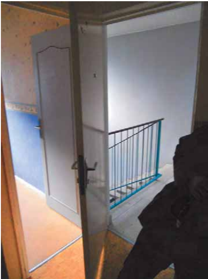
Ci-dessus photo Lucile Pierron BC-A L'absence d'espace intermédiaire entre l'entrée du logement et l'escalier constitue une source d'inconfort acoustique majeure.
