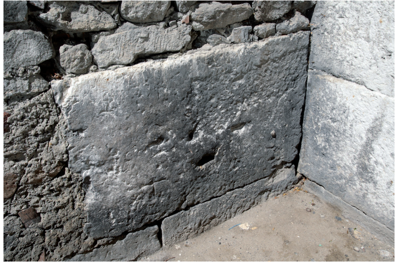
Fig. 18. Soubassement du mur gouttereau sud, 1 ère travée : parement extérieur de l'église abbatiale Saint-André-le-Haut de Vienne (Isère). Cliché : A. Baud et A. Flammin, Université Lyon 2-UMR 5138.
