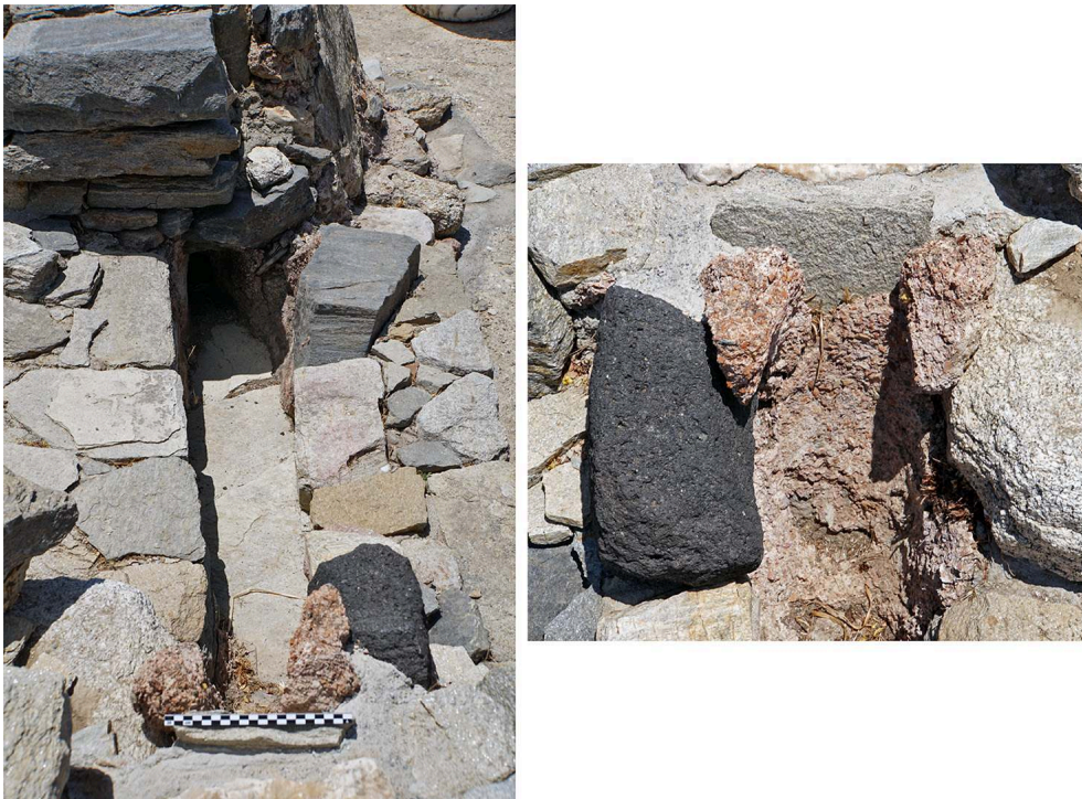
Fig. 56. Canalisation nord-sud se déversant dans la citerne de la pièce n° 4 et détail de l'épais mortier de tuileau avec remploi d'une pièce de moulin délien.
