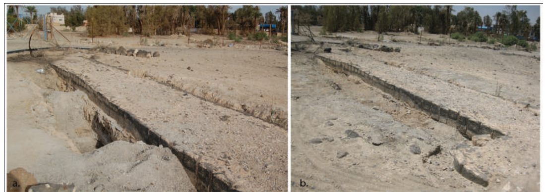
Fig.36 :Vue du chantier G après le remplissage de terre de part et d'autre du mur a) avant les travaux b) après les travaux (LAA)
